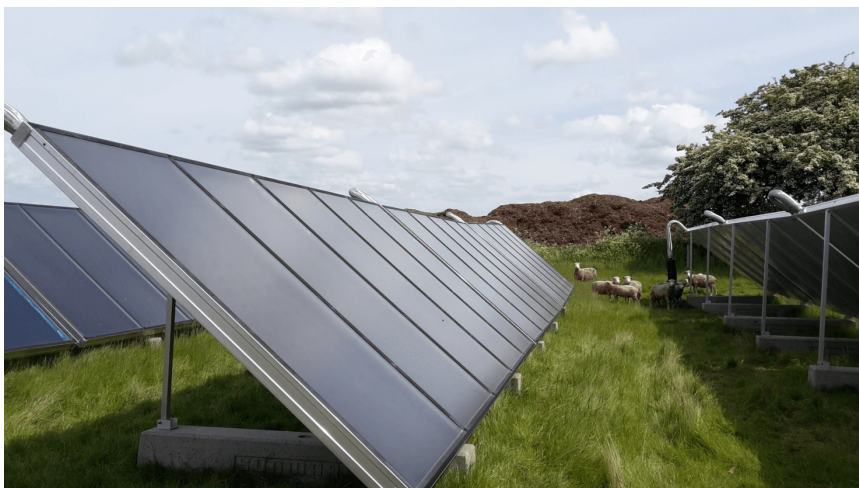
Figur C.12 – Solvarmeanlæg ved fjernvarmeværk.
