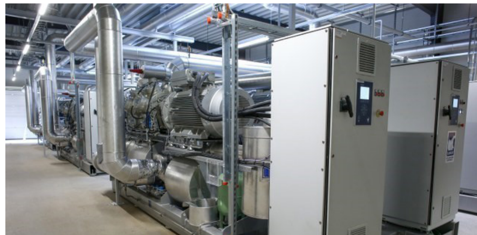
Varmepumpeanlægget i Kalundborg, Enheden forrest på billedet med de to elskabe, udgør den ene halvdel af et "varmepumpesæt". Det samlede anlæg består af i alt 6 lignende enheder.
